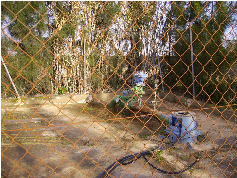
Sondeo de abastecimiento la Higuera (Sondeo III-3-09).
