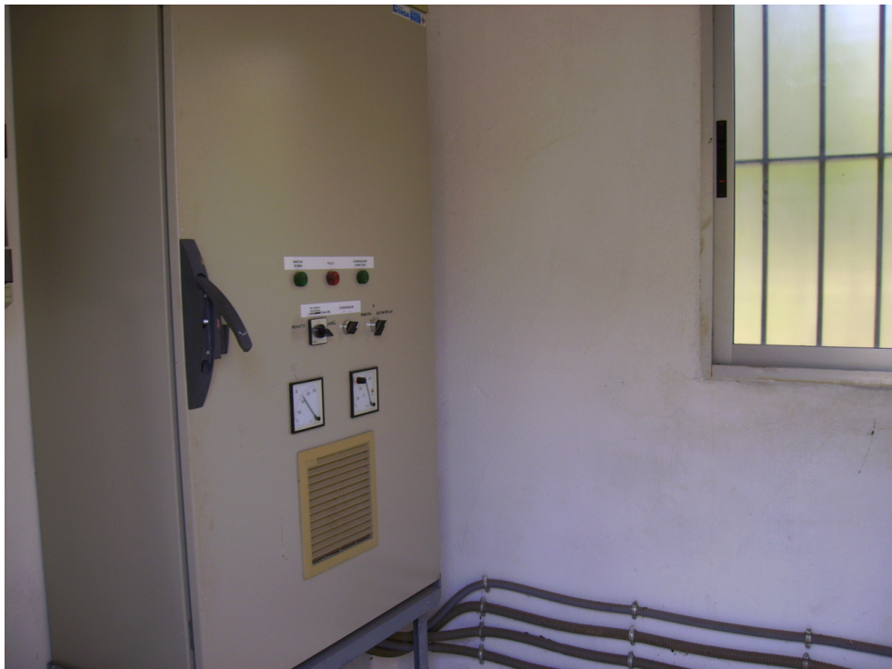
Cuadro eléctrico del sondeo Matalagrana 2
