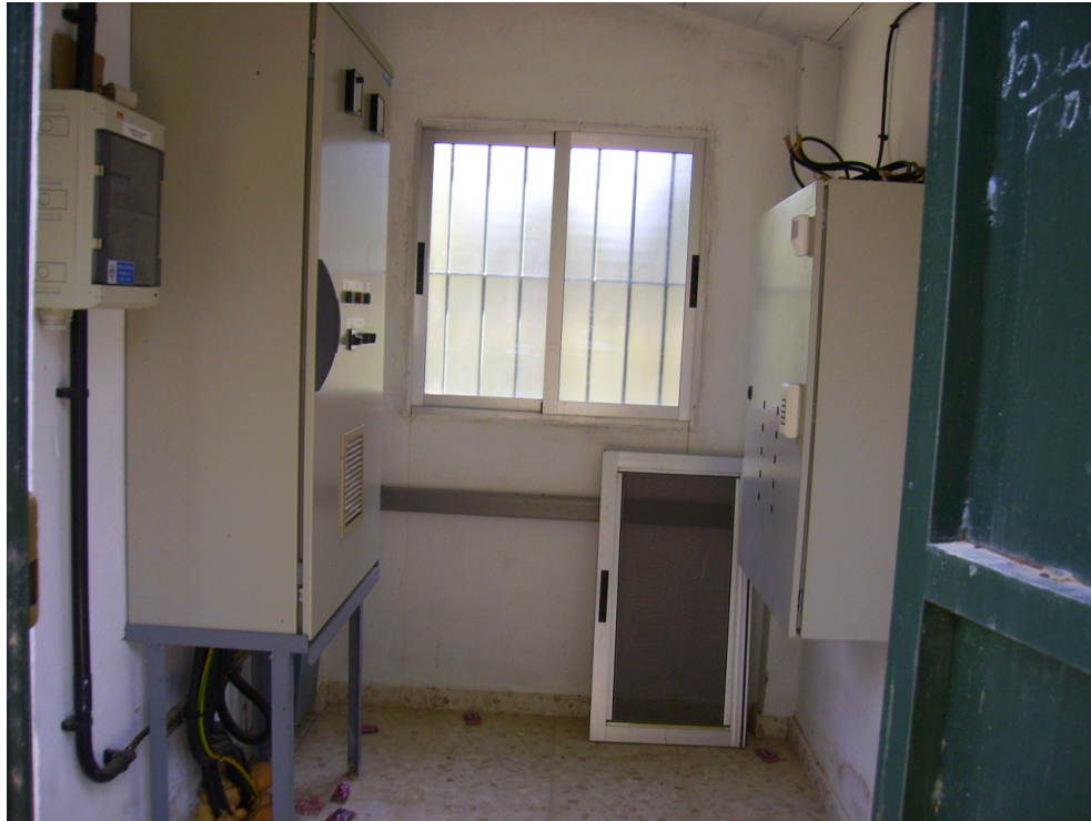
Cuadro eléctrico del sondeo Matalagrana 1
