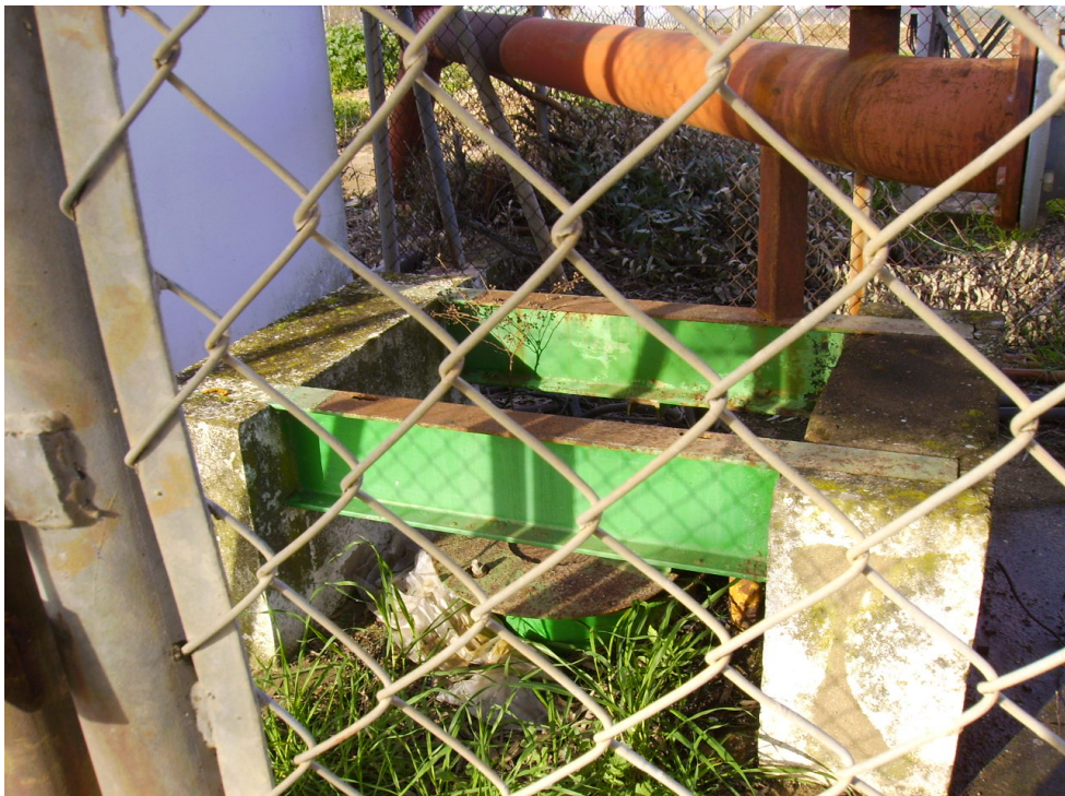
Sondeo de reserva a 10 m. del sondeo de abastecimiento el Eucalipto).
